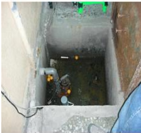
地下室集水槽
