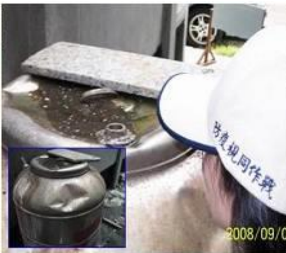
儲水桶鐵蓋凹陷處
