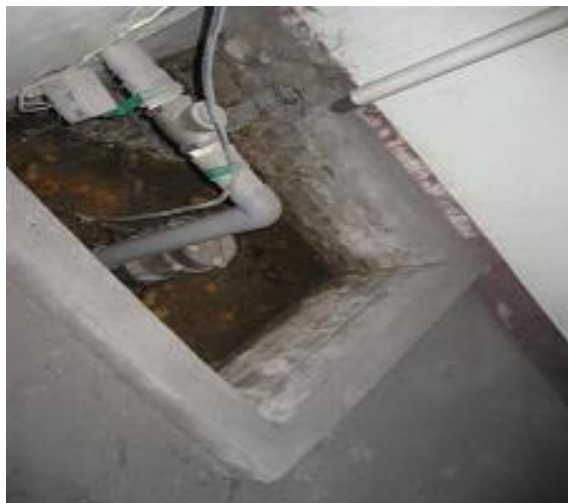
地下室儲水槽
