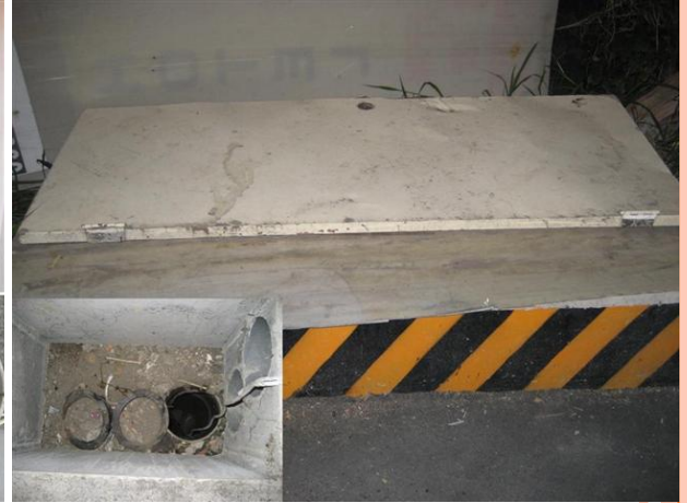
電信電纜管道
