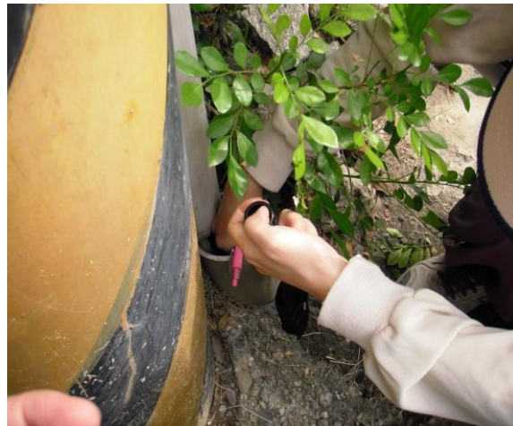
地下電纜引上管
