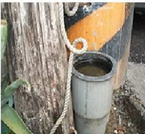
台電地下電纜引上管
