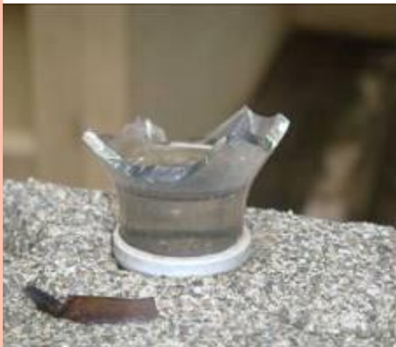
防竊盜圍牆碎玻璃
